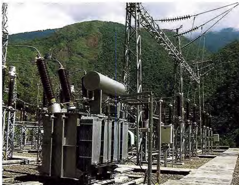
Patio de llaves Subestación San Gabán II. Switchyard at the San Gaban II Sub Station
