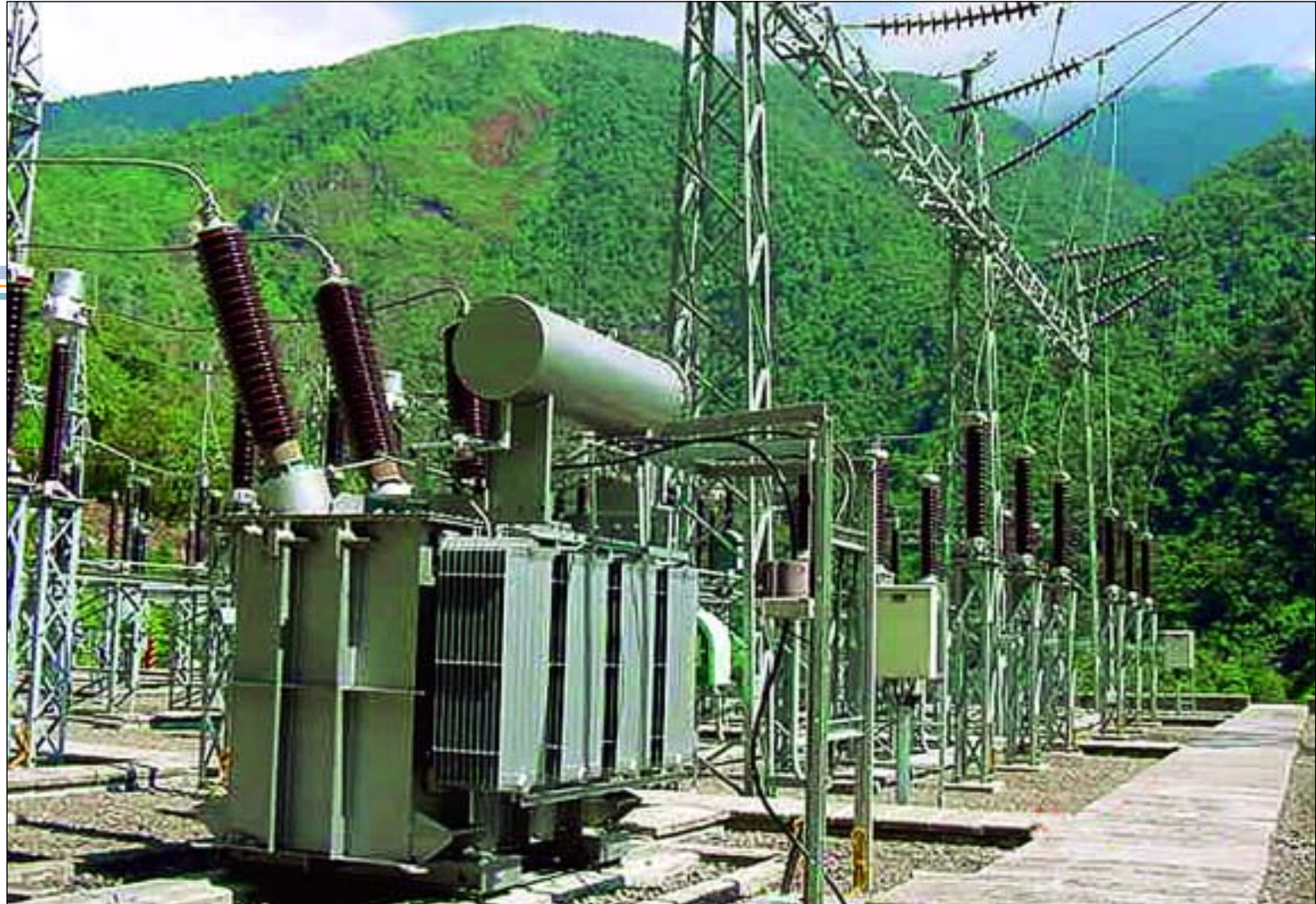
Patio de llaves y transformador de Servicios Auxiliares Sub-Estación San Gabán II. Switchyard and Auxiliary Services transformer San Gabán II Substation
