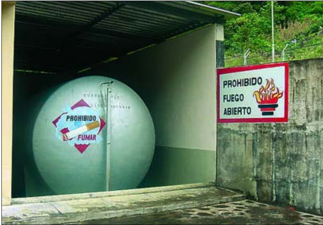
Letreros de seguridad: Fuego Abierto, Tanque de petróleo - Grupo de Emergencia, S.E.S.G.B. II. Safety signs. Open Fire, Oil tank - Emergency Generating Set San Gabán II Hydroelectric Power Plant
