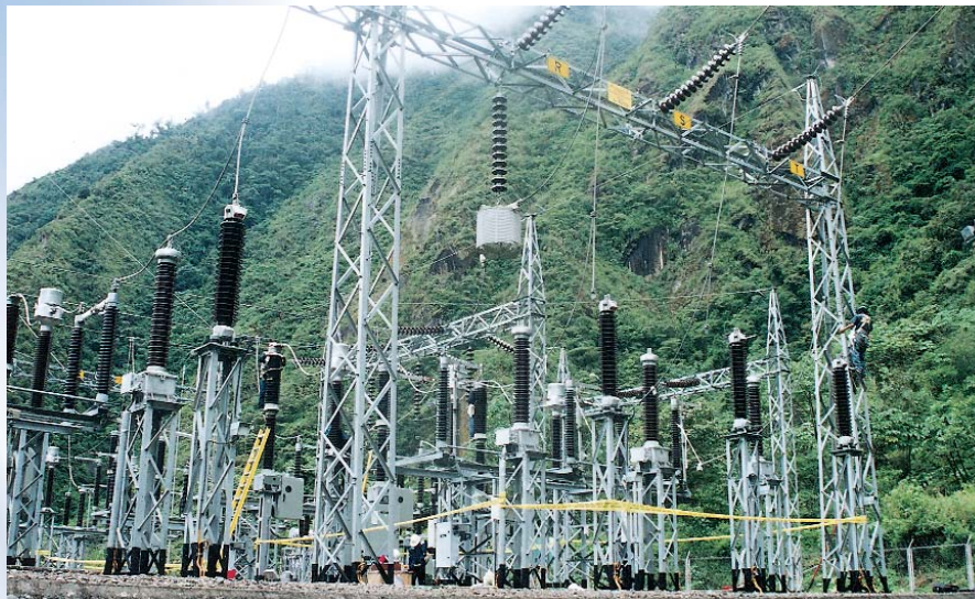
Sub Estación de Transformación – C.H. San Gabán II / Transformer substation - San Gaban II Hydroelectric Station
