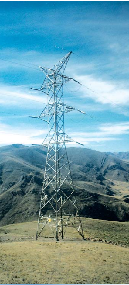
Torre de transmisión / Transmission tower
