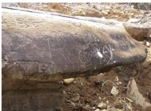
Fig. 85: Graffiti hecho con un instrumento cortante, causando un daño irreparable al bloque 5 (Foto: Cortesía Consorcio Intersur)
