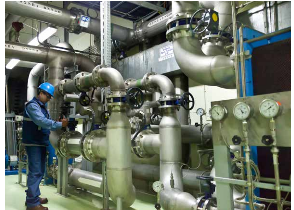
Control de la Operación de la Central Hidroeléctrica San Gabán II. Operations control of San Gabán II power station.
