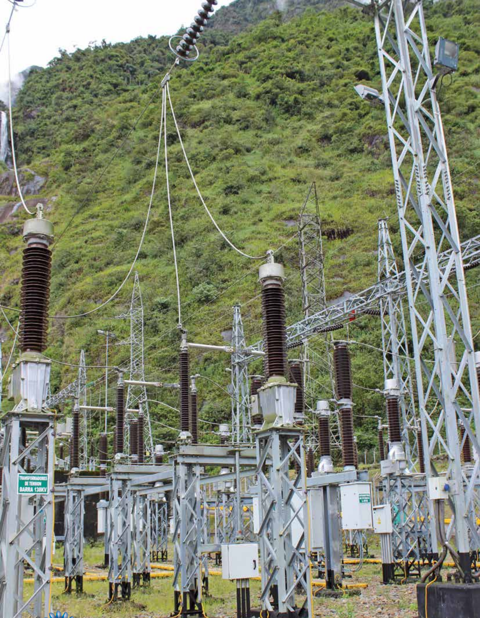
Patio de Llaves Sub Estación San Gabán II Switchyard at San Gabán II Substation
