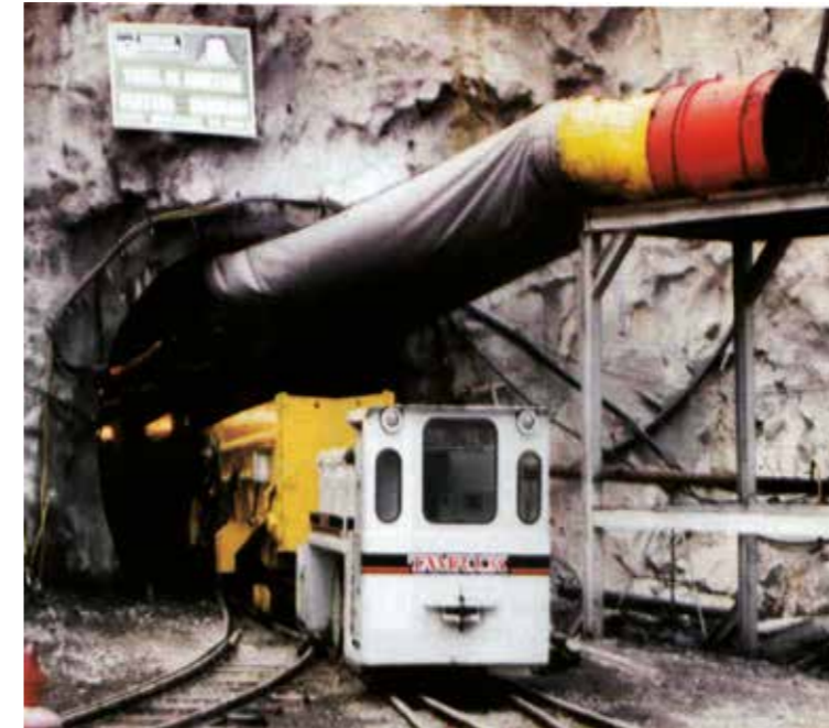
Salida de la Ventana de Urahuasi: Equipo de Acarreo Haggloader y Locomotora
