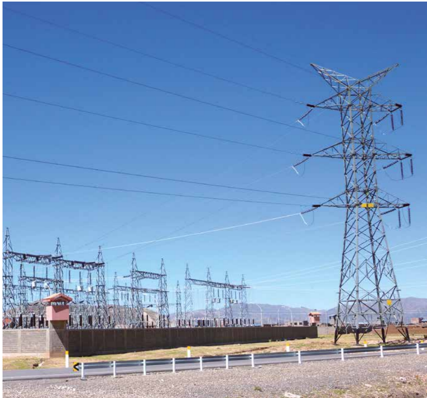
Subestación Azángaro, punto de entrega de energía al sistema interconectado
