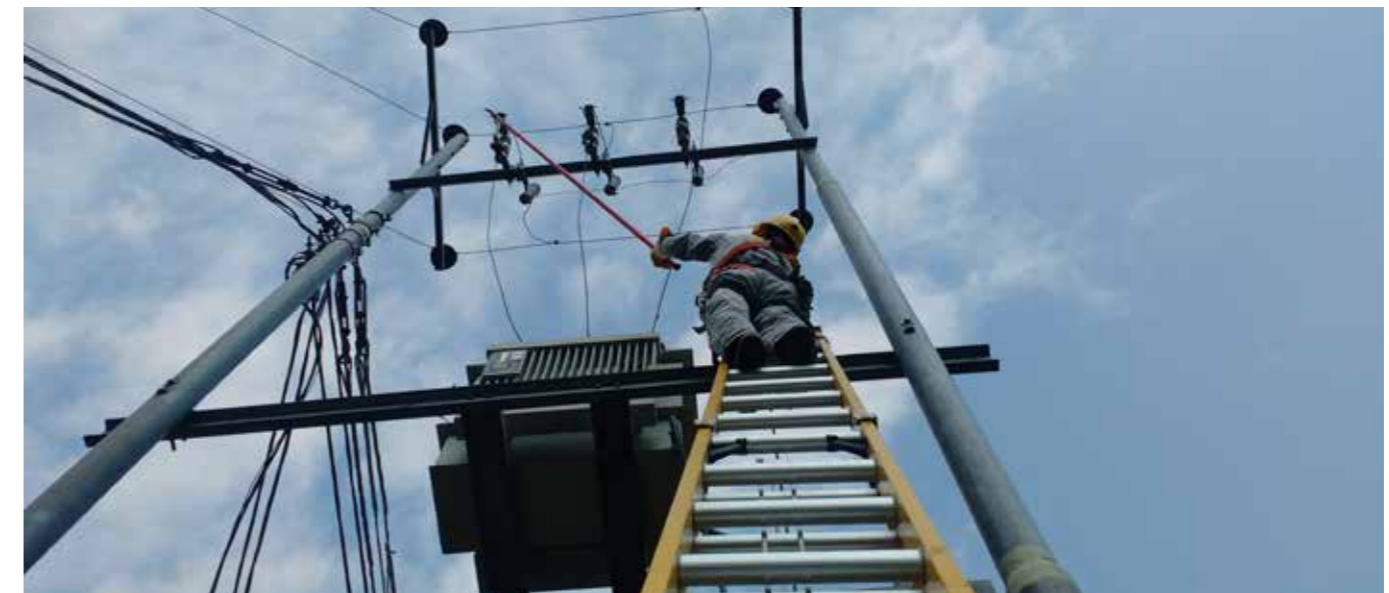
Mantenimiento de LT y SE
